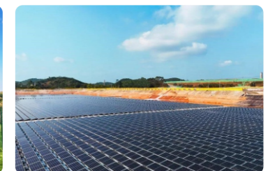
水面光伏系统 Floating photovoltaic systems
